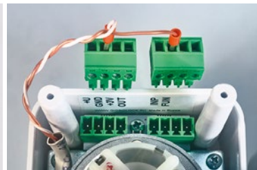
Фото 23. Подключение проводного выключателя
