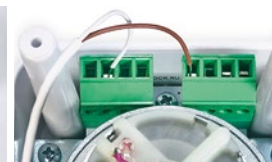
Фото 15. Подключение датчика к электроприводу
