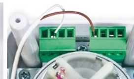
Фото 15. Подключение датчика к электроприводу
