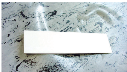
Рис. 11. Образование пузырей при несоблюдении требований по укладке
